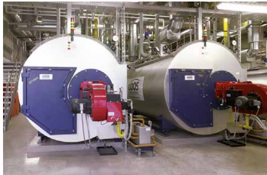
Der Dampfverbrauch wird ebenfalls überwacht
